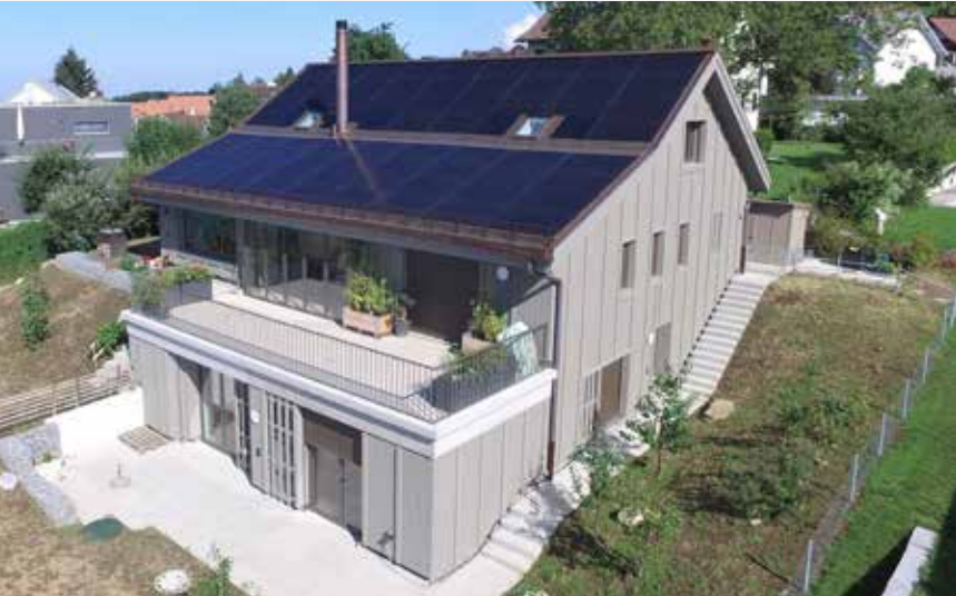
Indach Photovoltaik-Anlage auf einem Einfamilienhaus.
