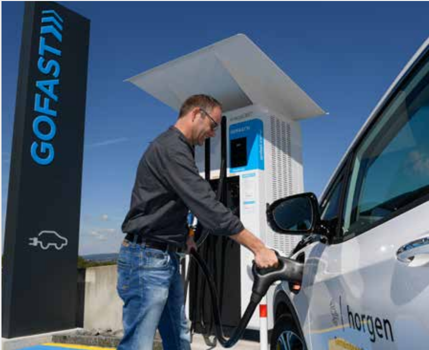
Roman Eberhard, Gruppenleiter Projektierung bei den Gemeindewerken Horgen, testet die neue E-Tankstelle an der A3.
